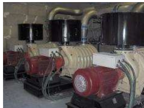
V-CENTRIF: Isle sur la Sorgue Waste water treatment
